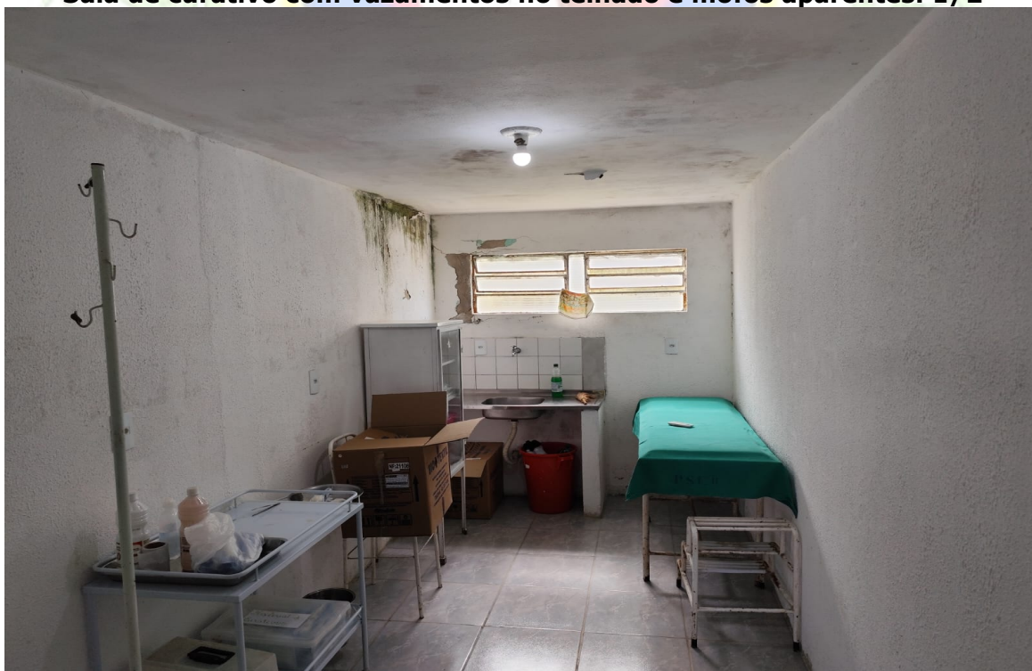
Sala de curativo com vazamentos no teto e mofos aparentes. 2/2
