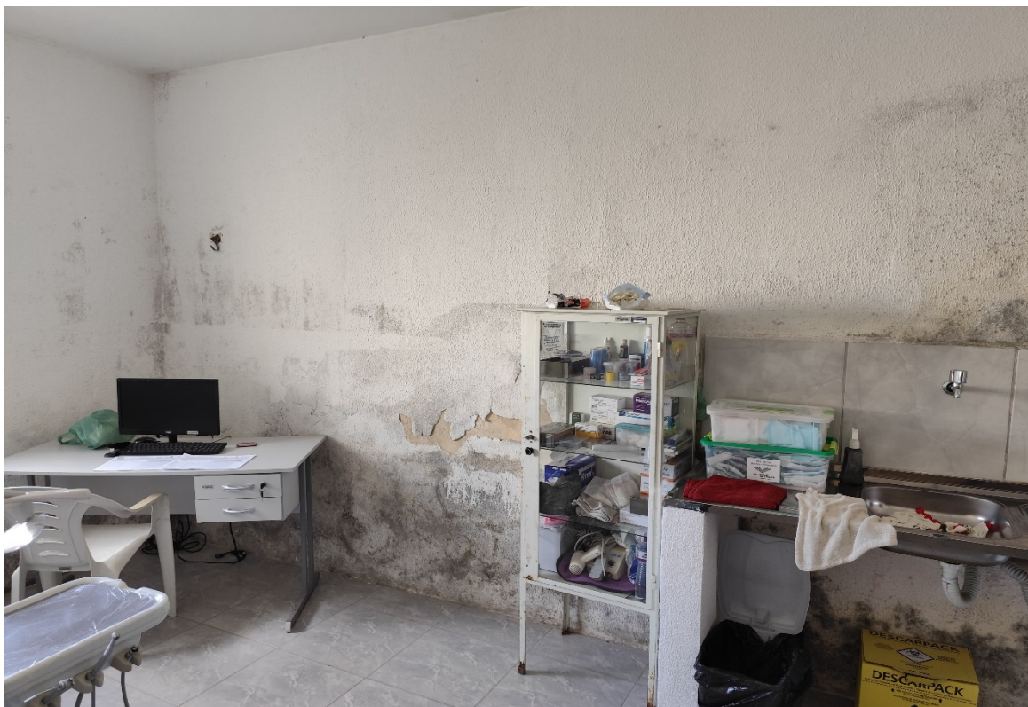
Sala de curativo com vazamentos no telhado e mofos aparentes. 1/2
